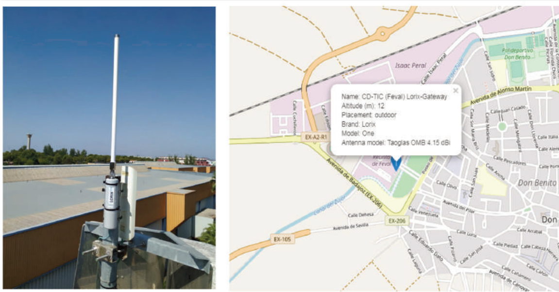
Figura 128 - Antena desplegada en FEVAL.
